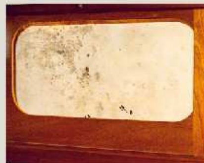
▲ Keine Dämmwirkung mehr: Besonders an Stellen mit mangelhafter Belüftung bilden sich auf der maroden Wandverkleidung schnell Stockflecken
